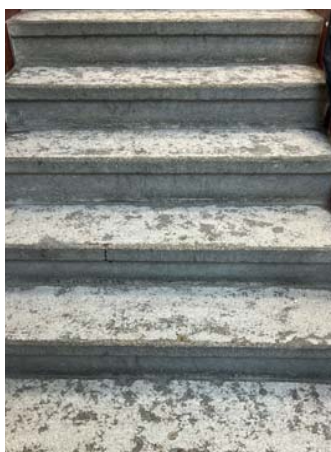
Schody před opravou...
